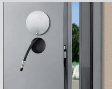
Bei Hochwassergefahr wird die Abdeckung geöffnet und das Ventil sichtbar.
