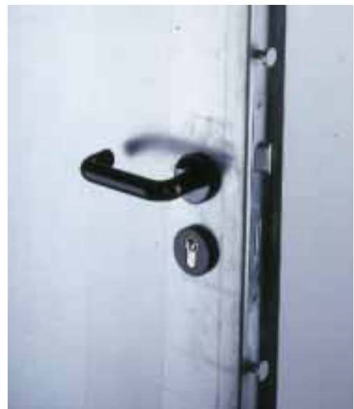
Sicherungsbolzen im Schlossbereich
