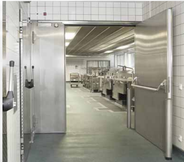
Feuerschutztür, 2-flügelig, geschliffene Oberfläche, in einer Großküche.
