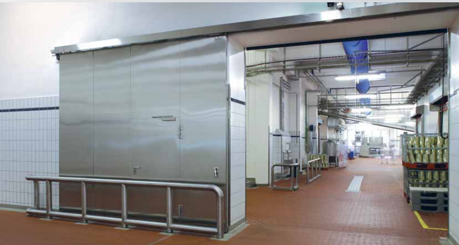
Feuerschutz-Schiebetor, T90-1 „Teckentrup E“, mit Schlupftür, in der Lebensmittelproduktion.
