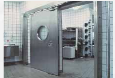
Feuerschutz-Schiebetor in einer Großküche.
